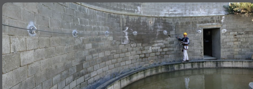
Depósito de aguas residuales. SADA (Lleida)
